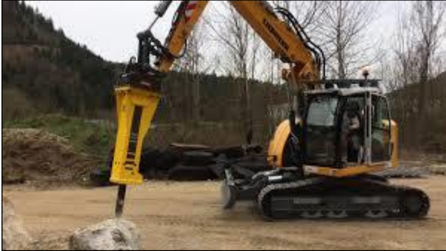
Photo 2 : Exemple de brise roche hydraulique
